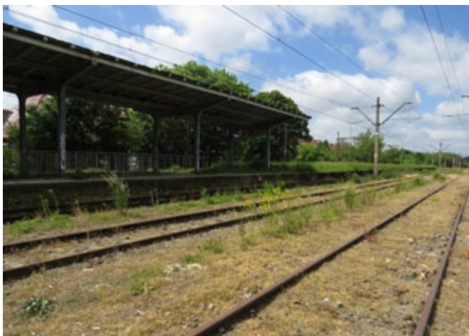
Fot. 2. Stan istniejący peronu Szczecin Pogodno
